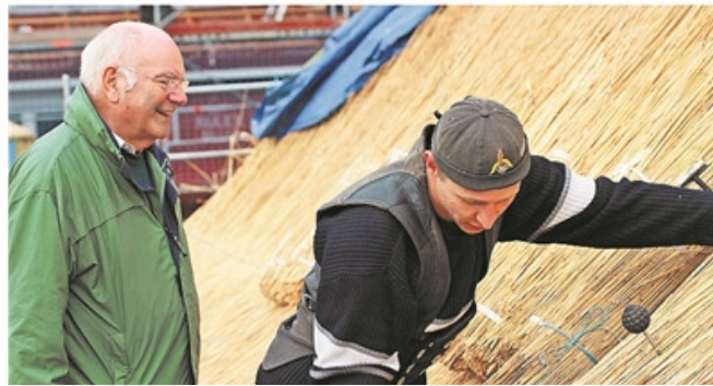
Dieter Kunze schaut Dachdecker Benjamin Behrens von der Firma Junker über die Schulter. Für 50 000 Euro wird das Dach erneuert.
